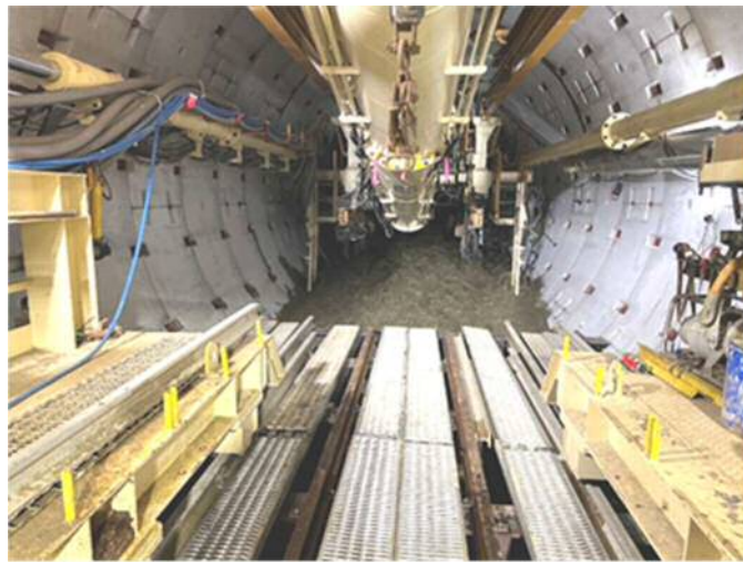
写真 出水時のシールドマシン内の状況
