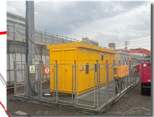
高圧受電設備
