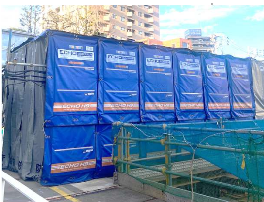
冷凍機への防音囲い対策（他現場事例）
