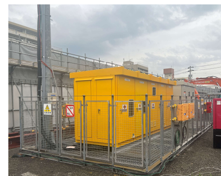
高圧受電設備
