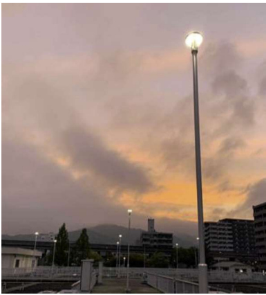
牛田浄水場 LED 照明
