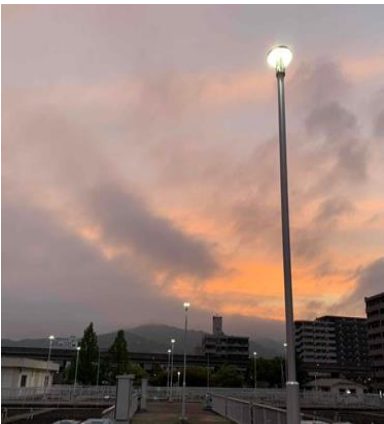
牛田浄水場 LED 照明
