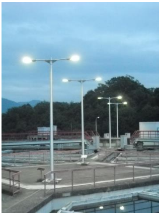
緑井浄水場 LED照明
