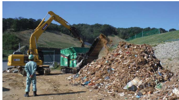
写真 1-2-5 玖谷埋立地内の移動式破砕機
