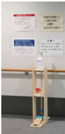
写真 12 廊下のアルコール消毒装置
