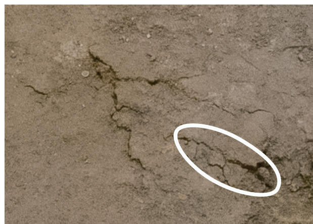
2024/12/16 亀裂 縦約 12.0cm 横約 22.3cm 白丸部分の亀裂が広がっている。
