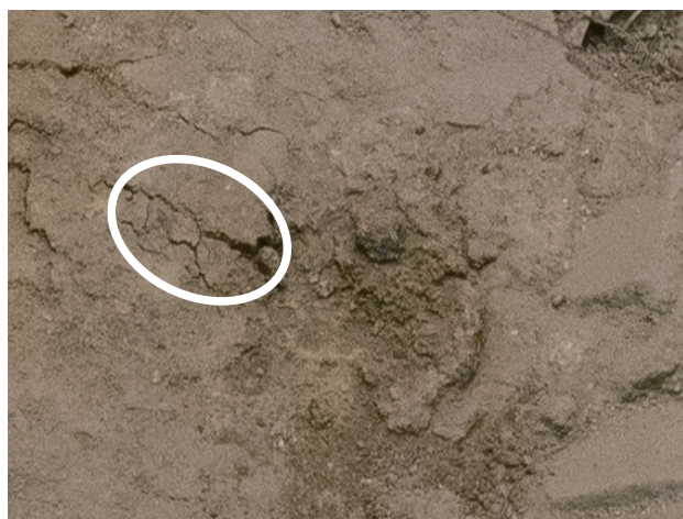
2024/12/16 析出物に大きな変化はみられない。 周辺の亀裂が広がっている。（（3）参照）
