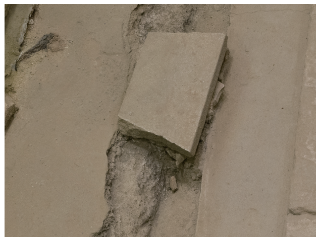
2024/12/16 崩落後から変化は見られない。
