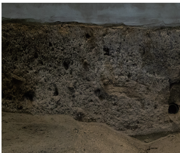
11/15 白い物質析出部分 拡大写真①
