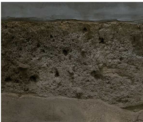
12/16 白い物質析出部分 拡大写真①
