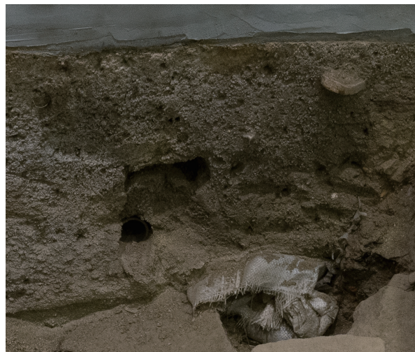
12/16 白い物質析出部分 拡大写真②
