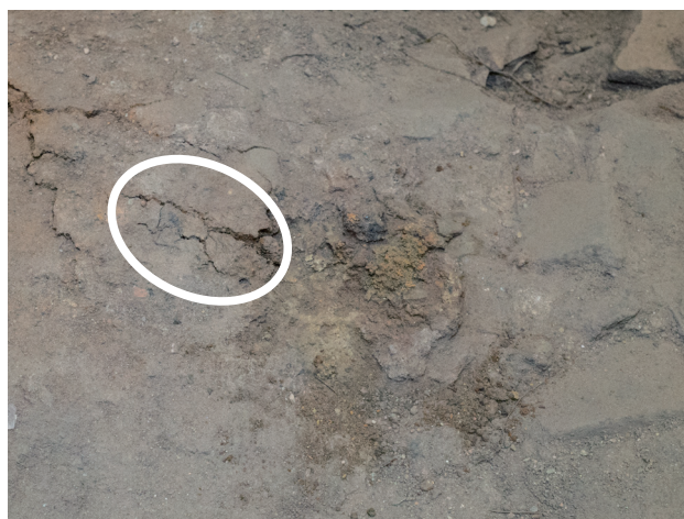
2024/11/15 析出物に大きな変化はみられない。 周辺の亀裂が広がっている。（（3）参照）
