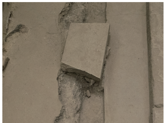
2024/11/15 崩落後から変化は見られない。
