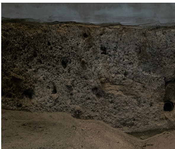
11/15 白い物質析出部分 拡大写真①
