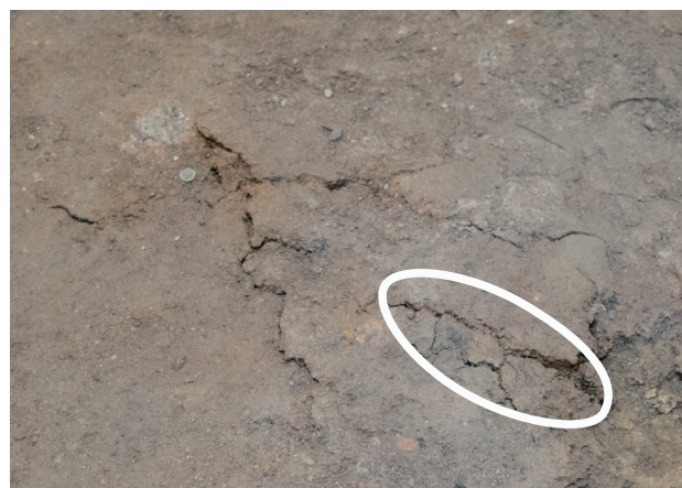
2024/11/15 亀裂 縦約 11.8cm 横約 22.0cm 白丸部分の亀裂が広がっている。
