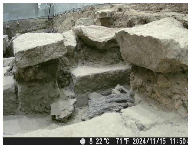
2024/11/15 定点カメラ画像 崩壊後から変化は見られない。
