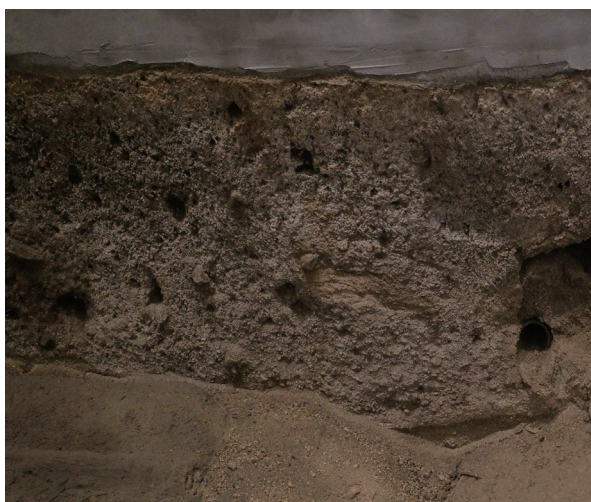
10/15 白い物質析出部分 拡大写真①
