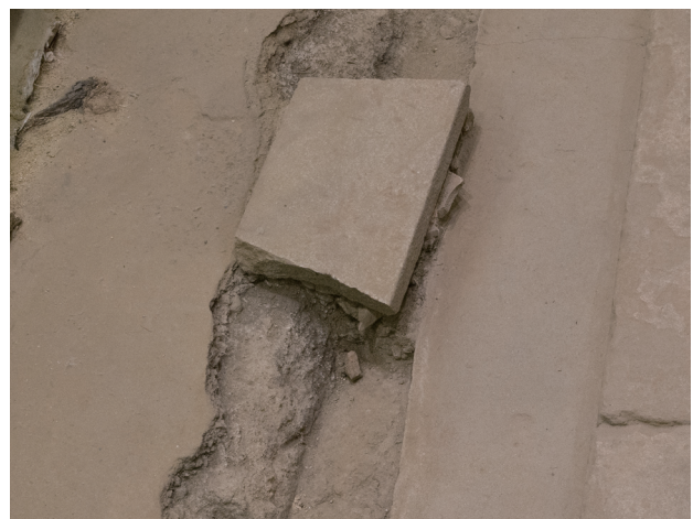
2024/10/15 崩落後から変化は見られない。
