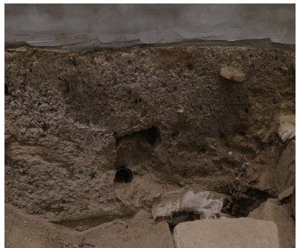
10/15 白い物質析出部分 拡大写真②
