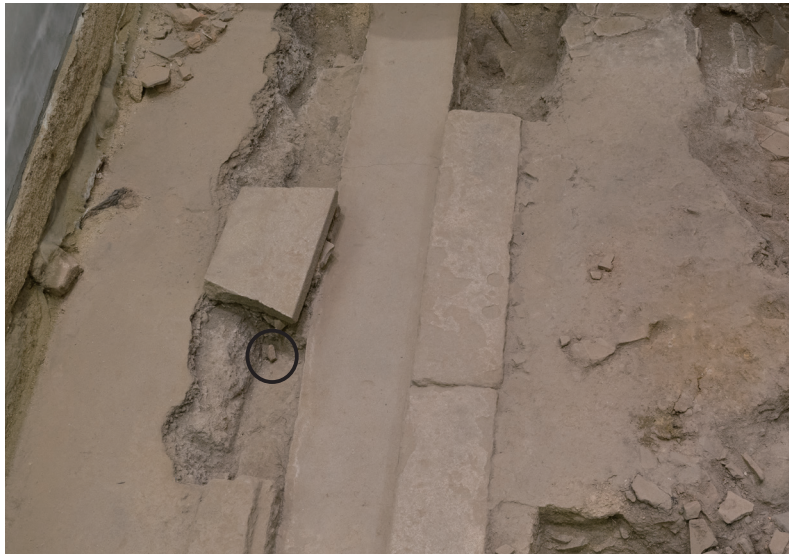
2024/8/15 レンガ片の崩落を確認。
