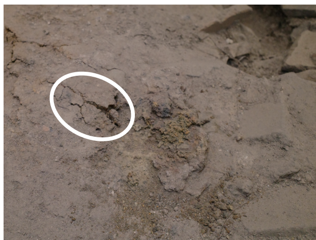
2024/10/15 析出物に大きな変化はみられない。 周辺の亀裂が広がっている。（（3）参照）
