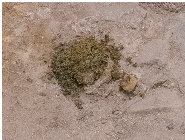
2022/10/13 析出した状況
