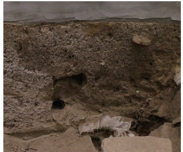
9/17 白い物質析出部分 拡大写真②
