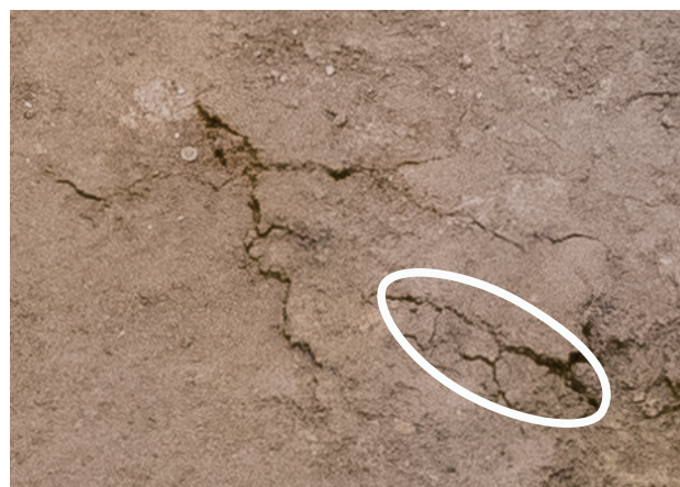
2024/10/15 亀裂 縦約 11.8cm 横約 22.0cm 白丸部分の亀裂が広がっている。
