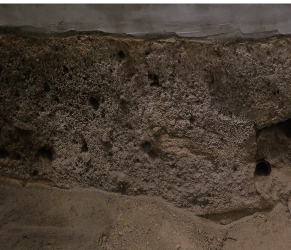
10/15 白い物質析出部分 拡大写真①
