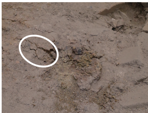
2024/9/17 析出物に大きな変化はみられない。 周辺の亀裂が広がっている。（（3）参照）
