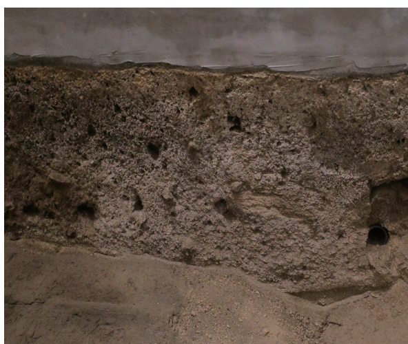
9/17 白い物質析出部分 拡大写真①
