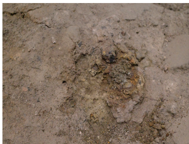
2023/9/14 析出物除去後の様子。
