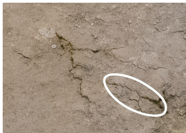
2024/8/15 亀裂 縦約 11.5cm 横約 21.6cm 白丸部分の亀裂が広がっている。
