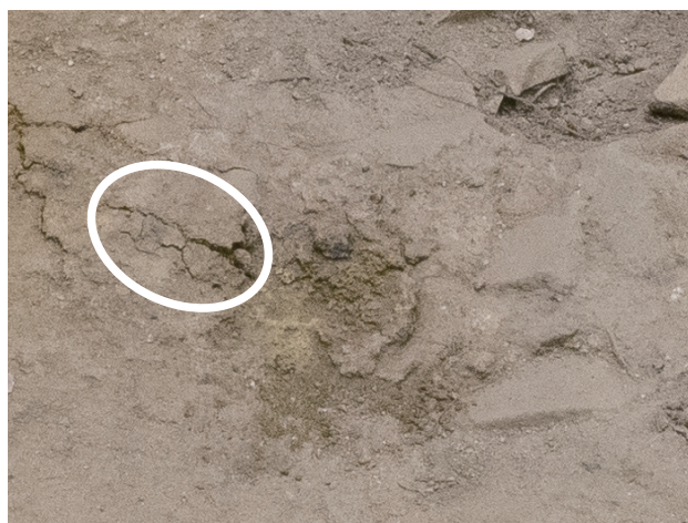
2024/8/15 析出物に大きな変化はみられない。 周辺の亀裂が広がっている。（（3）参照）
