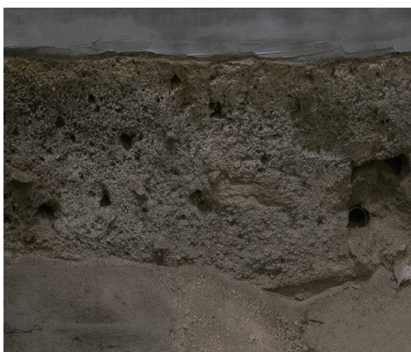
8/15 白い物質析出部分 拡大写真①
