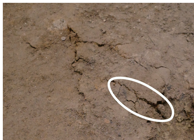
2024/7/16 亀裂 縦約 11.5cm 横約 21.2cm 白丸部分の亀裂が広がっている。
