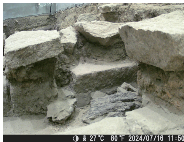
2024/7/16 定点カメラ画像 崩壊後から変化は見られない。
