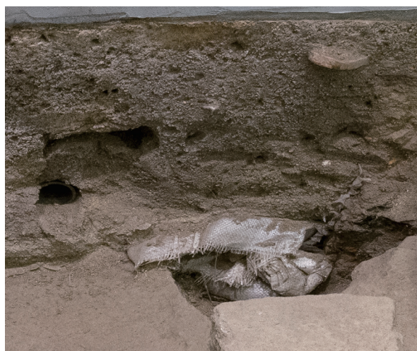
6/14 白い物質析出部分 拡大写真②
