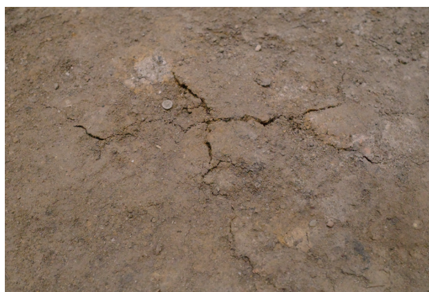
2023/4/24 亀裂 縦約 5.4cm 横約 12.6cm
