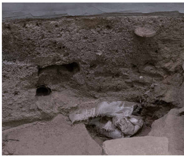
7/16 白い物質析出部分 拡大写真②
