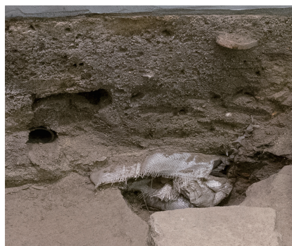
6/14 白い物質析出部分 拡大写真②
