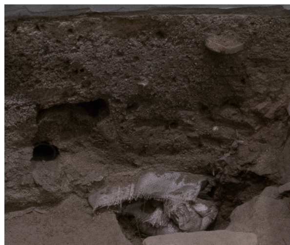
5/15 白い物質析出部分 拡大写真②
