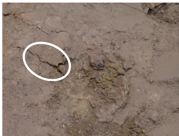
2024/6/14 析出物に大きな変化はみられない。 周辺の亀裂が広がっている。（（3）参照）
