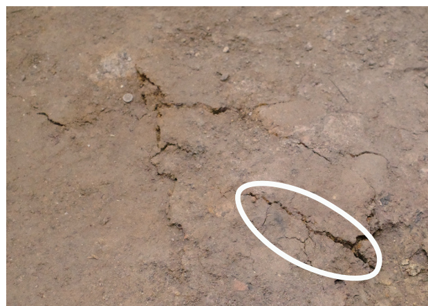
2024/6/14 亀裂 縦約 11.5cm 横約 20.7cm 白丸部分の亀裂が広がっている。
