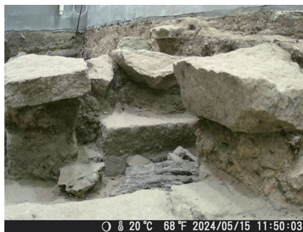
2024/5/15 定点カメラ画像 崩壊後から変化は見られない。
