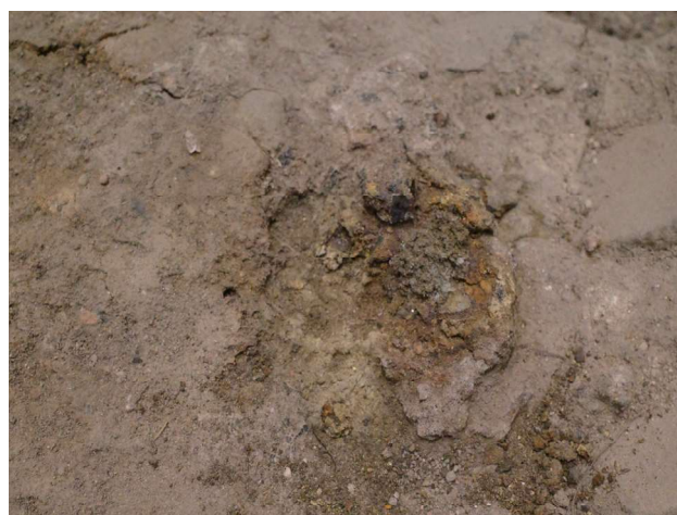
2023/9/14 析出物除去後の様子。
