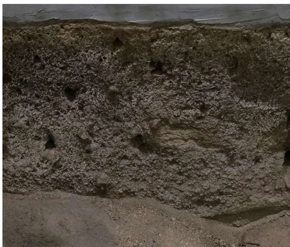
4/15 白い物質析出部分 拡大写真①
