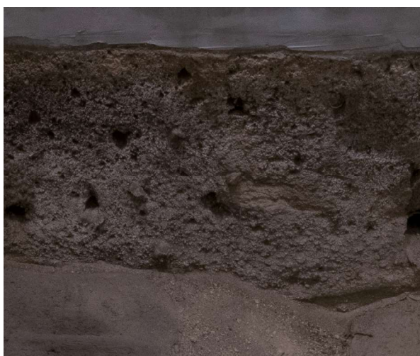
5/15 白い物質析出部分 拡大写真①
