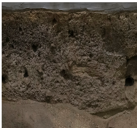
4/15 白い物質析出部分 拡大写真①
