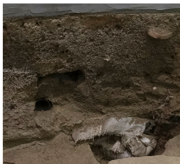
4/15 白い物質析出部分 拡大写真②
