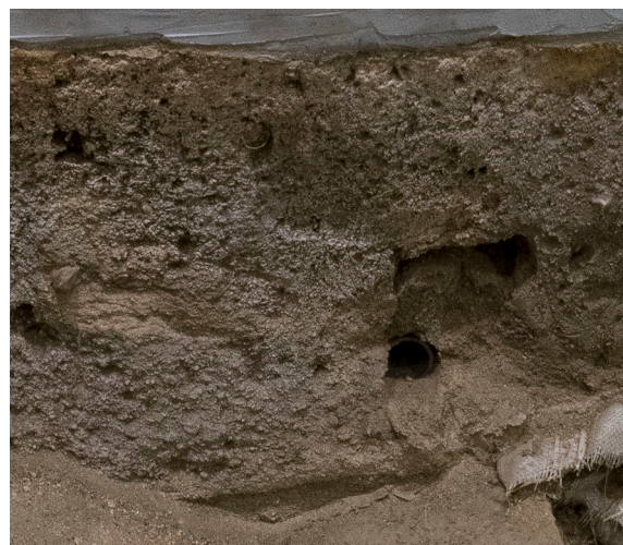
3/13 白い物質析出部分 拡大写真②
