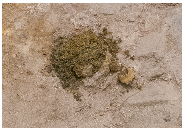
2022/10/13 析出した状況
