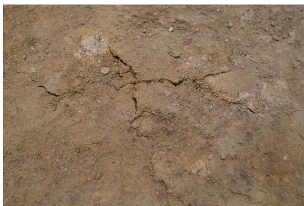
2023/4/24 亀裂 縦約 5.4cm 横約 12.6cm
