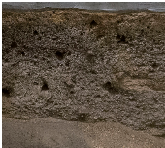
3/13 白い物質析出部分 拡大写真①
