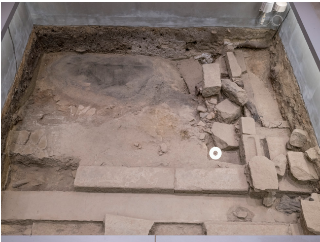
白丸部分に亀裂を確認した
