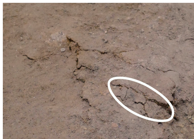
2024/9/17 亀裂 縦約 11.6cm 横約 21.6cm 白丸部分の亀裂が広がっている。
