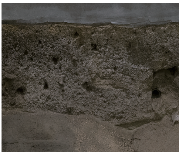
8/15 白い物質析出部分 拡大写真①
