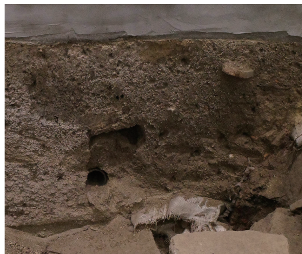
9/17 白い物質析出部分 拡大写真②
