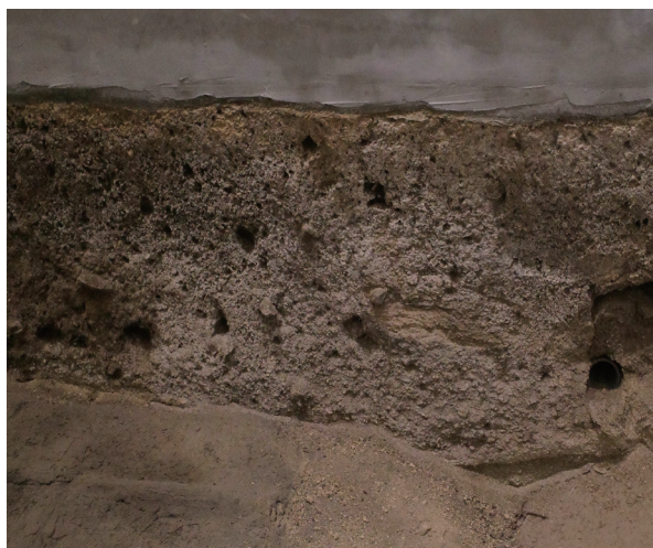
9/17 白い物質析出部分 拡大写真①
