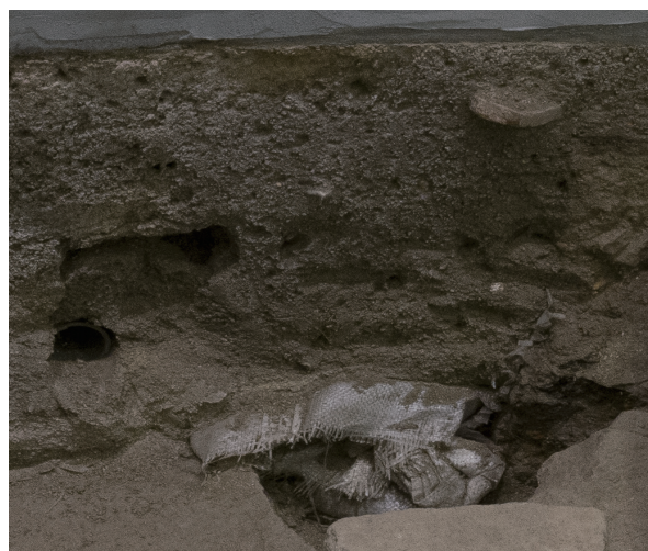
8/15 白い物質析出部分 拡大写真②
