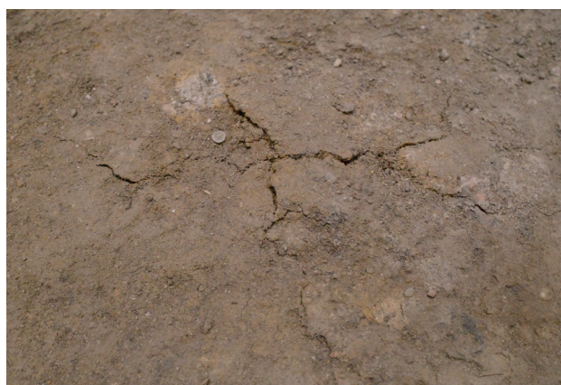
2023/4/24 亀裂 縦約 5.4cm 横約 12.6cm
