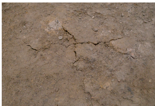
2023/4/24 亀裂 縦約 5.4cm 横約 12.6cm
