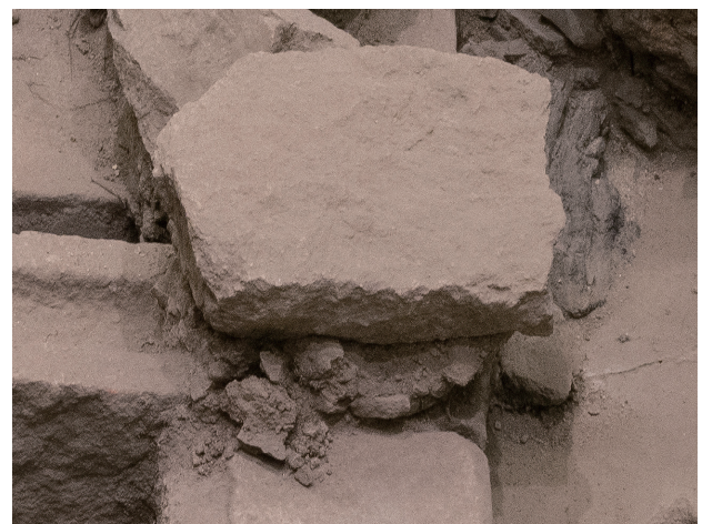
2024/7/16 下層部の土層部分が崩壊した。
