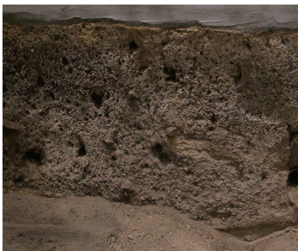
6/14 白い物質析出部分 拡大写真①
