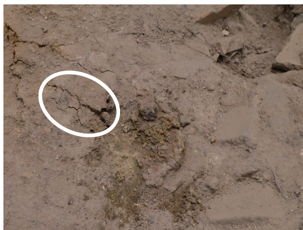
2024/7/16 析出物に大きな変化はみられない。 周辺の亀裂が広がっている。（（3）参照）
