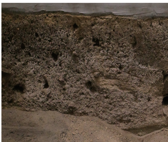
6/14 白い物質析出部分 拡大写真①
