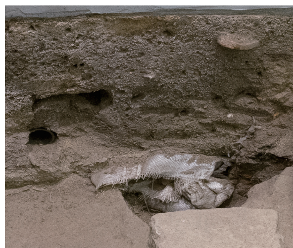
6/14 白い物質析出部分 拡大写真②
