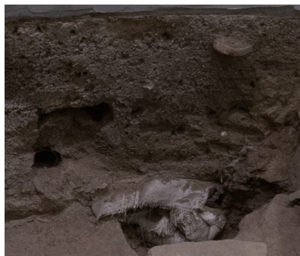
5/15 白い物質析出部分 拡大写真②
