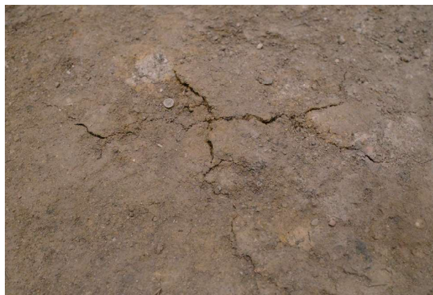
2023/4/24 亀裂 縦約 5.4cm 横約 12.6cm
