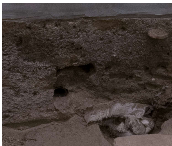
5/15 白い物質析出部分 拡大写真②
