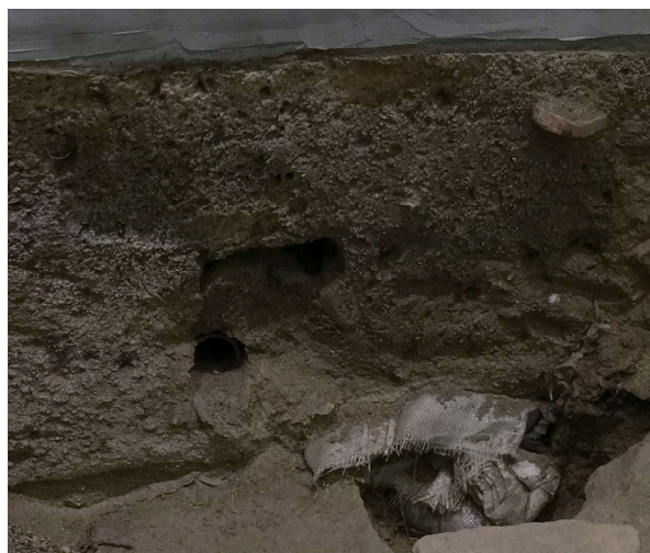
4/15 白い物質析出部分 拡大写真②
