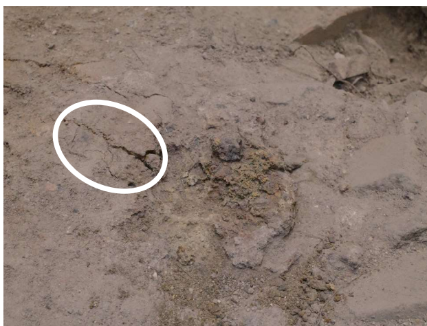
2024/5/15 析出物に大きな変化はみられない。 周辺の亀裂が広がっている。
