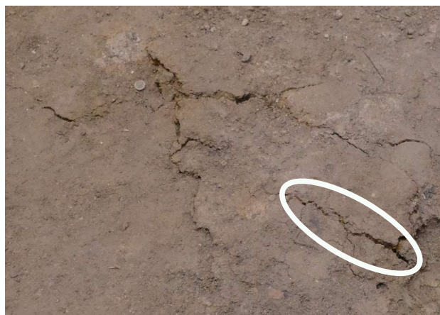
2024/5/15 亀裂 縦約 11.5cm 横約 20.3cm 白丸部分の亀裂が広がっている。
