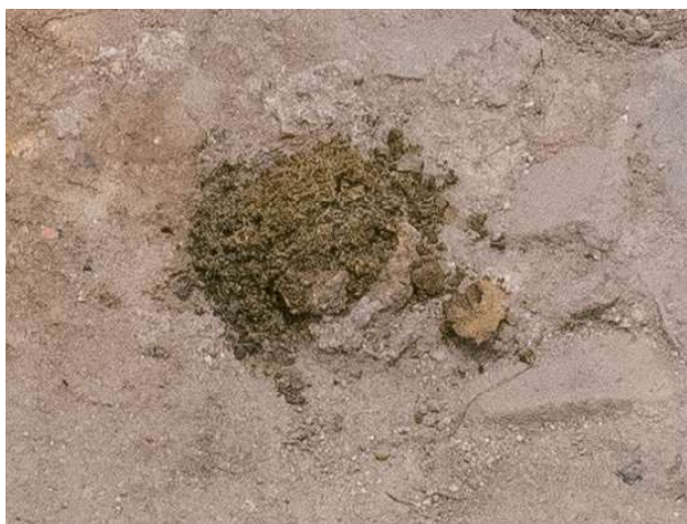
2022/10/13 析出した状況
