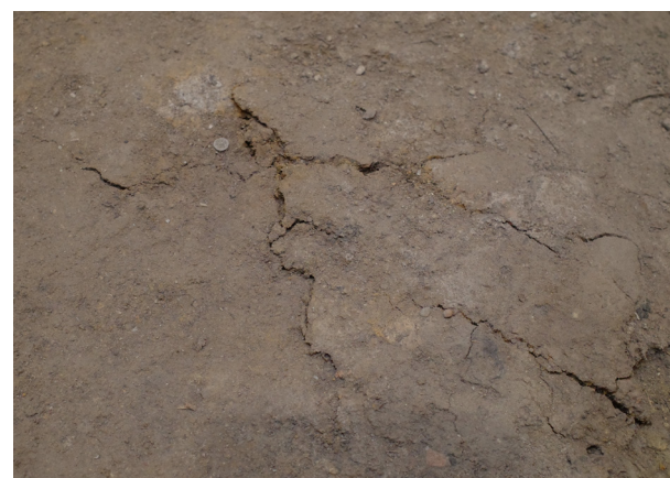
2024/4/15 亀裂 縦約 11.4cm 横約 20cm 前月から大きな変化は見られない。
