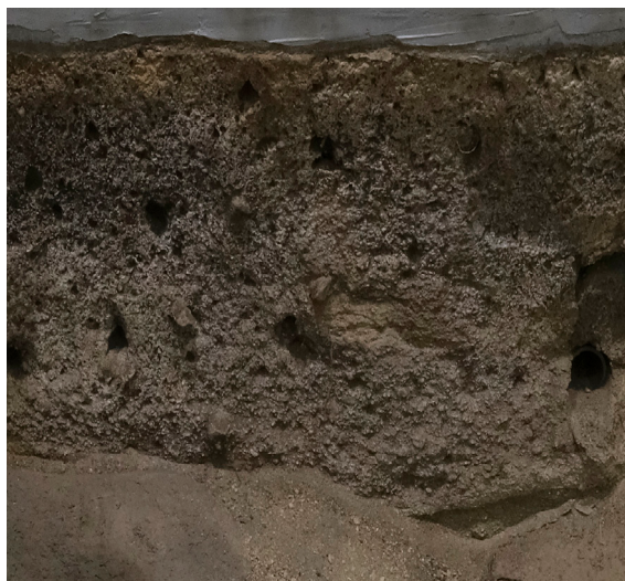
4/15 白い物質析出部分 拡大写真①
