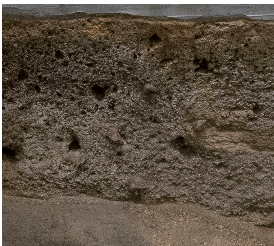
3/13 白い物質析出部分 拡大写真①
