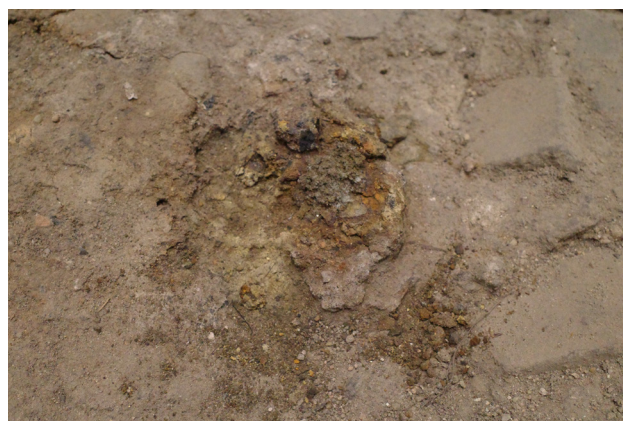
2023/9/14 析出物除去後の様子。
