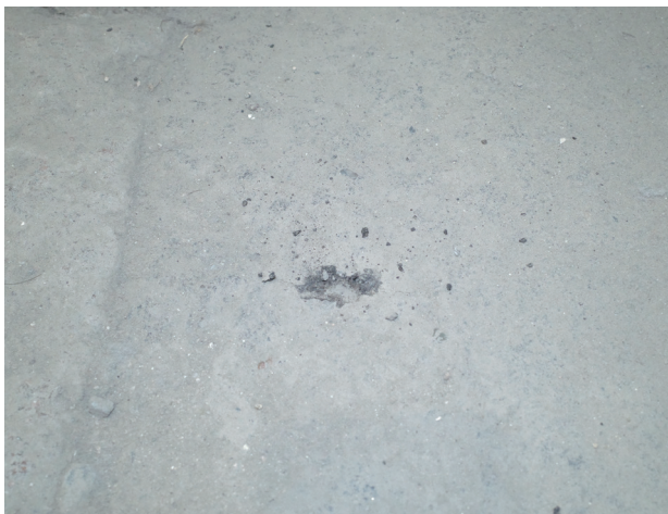
2025/3/14 陥没接写 長辺約 3cm 変化は見られない。
