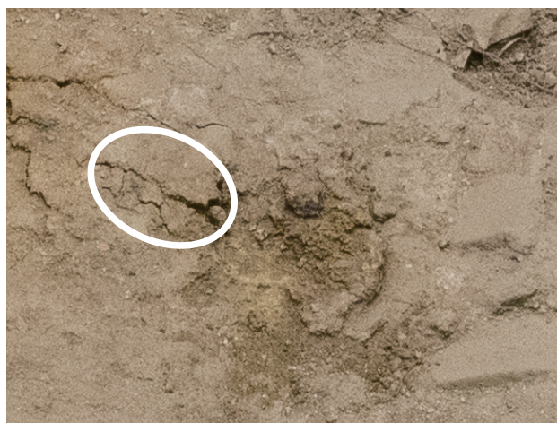
2025/3/14 析出物に大きな変化はみられない。 周辺の亀裂が広がっている。（（3）参照）
