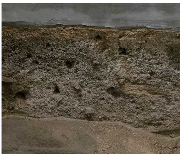
2025/3/14 析出部分 拡大写真①
