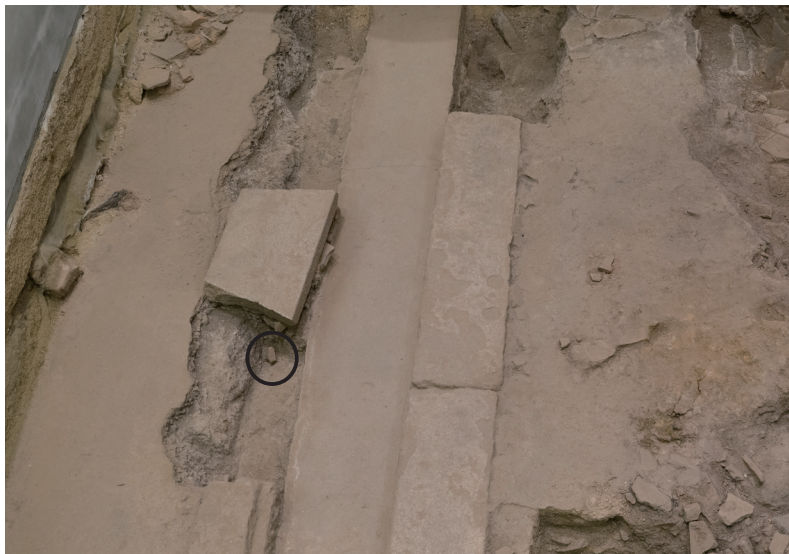
2024/8/15 レンガ片の崩落を確認。
