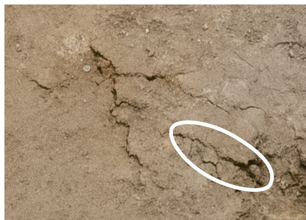
2025/3/14 亀裂 縦約 12.2cm 横約 24.2cm 白丸部分の亀裂が広がり、2022 年 4 月時点と比べて約 2.1cm 盛り上がっている。
