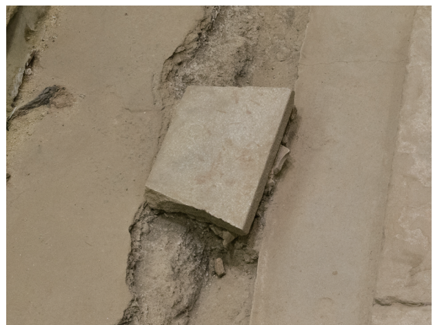
2025/3/14 崩落後から変化は見られない。
