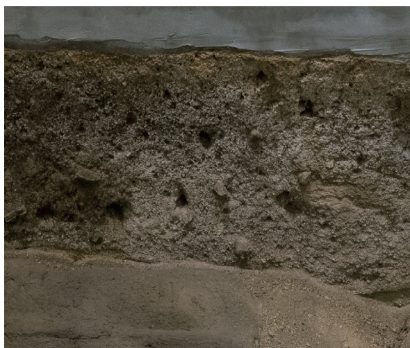
2025/2/17 析出部分 拡大写真①
