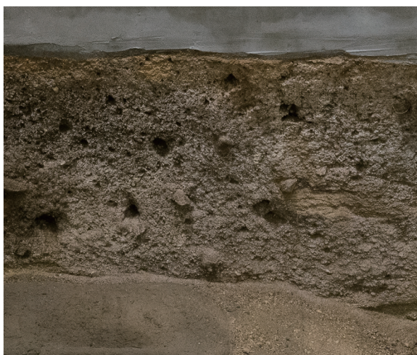
2025/1/15 析出部分 拡大写真①
