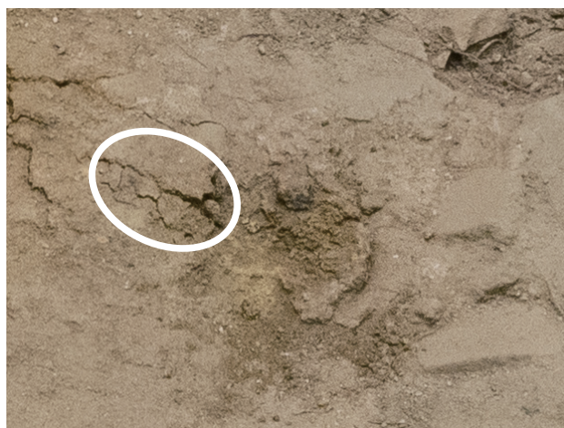
2025/2/17 析出物に大きな変化はみられない。 周辺の亀裂が広がっている。（（3）参照）
