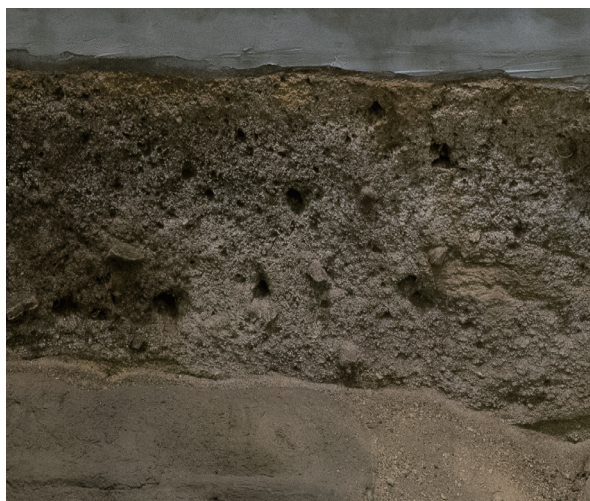
2025/2/17 析出部分 拡大写真①
