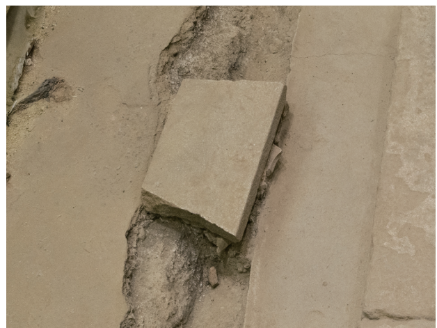
2025/2/17 崩落後から変化は見られない。
