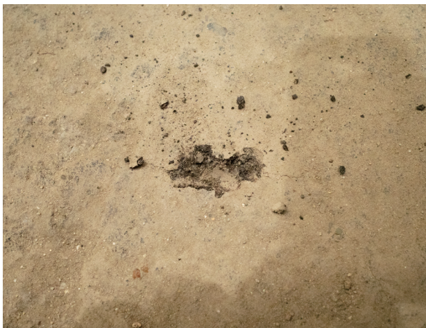
2025/2/17 陥没接写 長辺約 3cm
