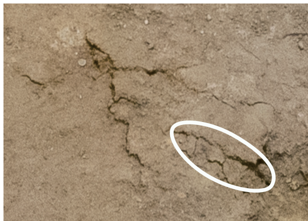
2025/2/17 亀裂 縦約 12.1cm 横約 24.0cm 白丸部分の亀裂が広がっている。
