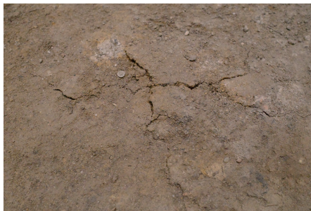
2023/4/24 亀裂 縦約 5.4cm 横約 12.6cm
