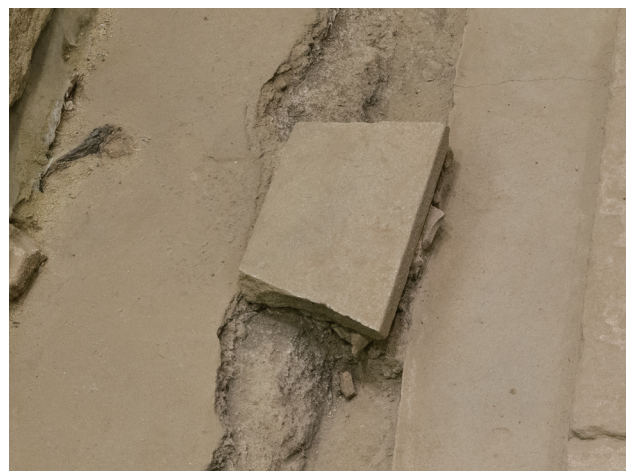
2025/1/15 崩落後から変化は見られない。
