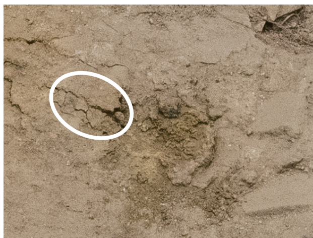
2025/1/15 析出物に大きな変化はみられない。 周辺の亀裂が広がっている。（（3）参照）
