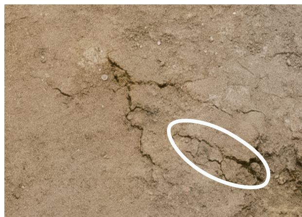
2025/1/15 亀裂 縦約 12.3cm 横約 24.0cm 白丸部分の亀裂が広がっている。
