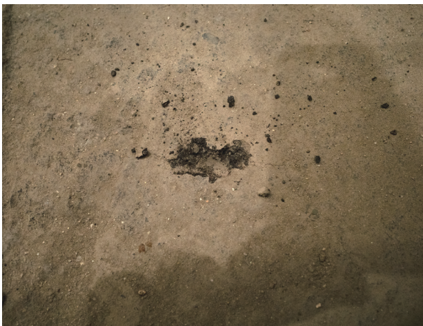
2025/1/15 陥没接写 長辺約 3cm
