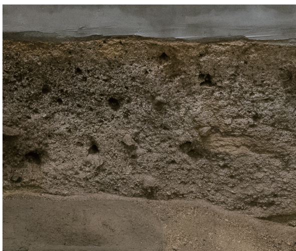
2025/1/15 析出部分 拡大写真①
