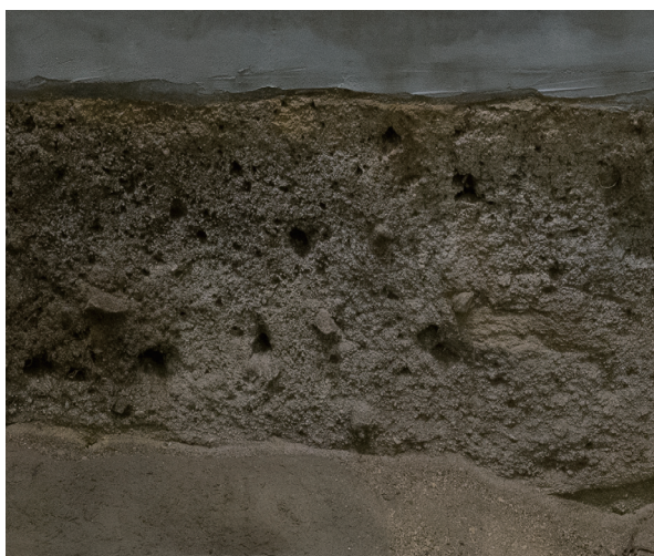
2024/12/16 析出部分 拡大写真①
