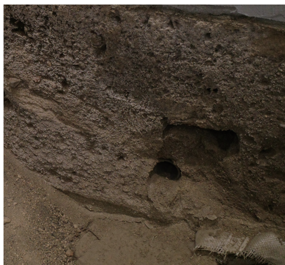
3/13 白い物質析出部分 拡大写真①
