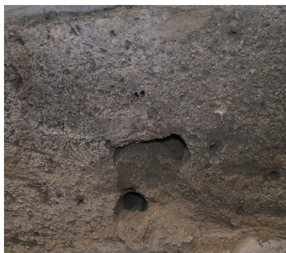
2/15 白い物質析出部分 拡大写真②
