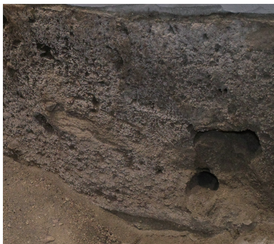
2/15 白い物質析出部分 拡大写真①
