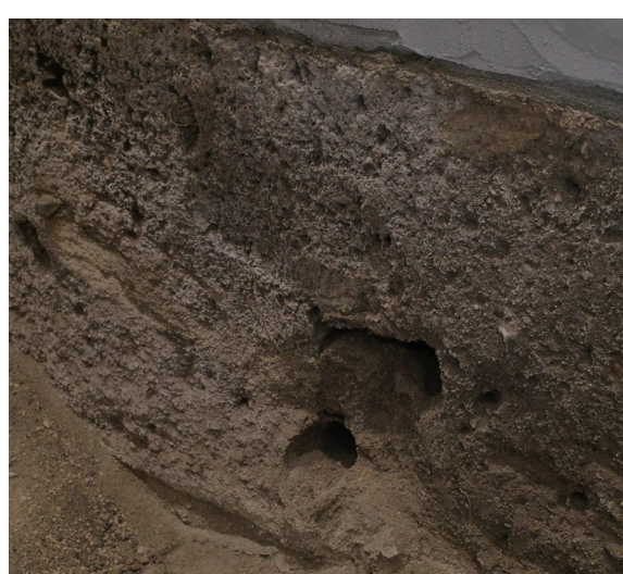
3/13 白い物質析出部分 拡大写真②
