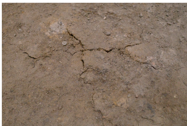
2023/4/24 亀裂 縦約 5.4cm 横約 12.6cm
