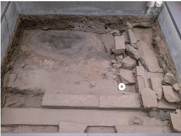
白丸部分に亀裂を確認した
