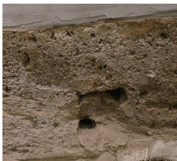
11/17 白い物質析出部分 拡大写真②
