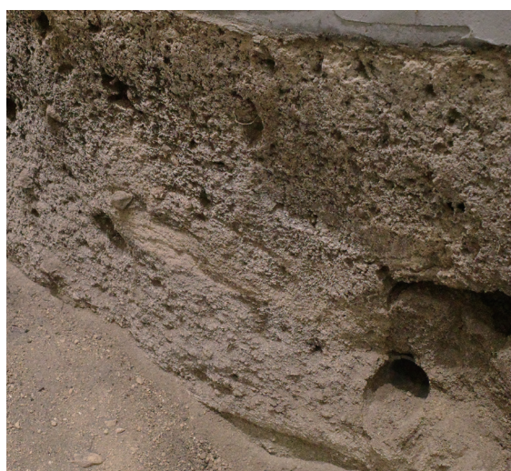
11/17 白い物質析出部分 拡大写真①
