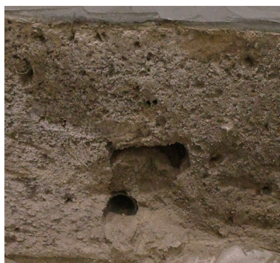
12/15 白い物質析出部分 拡大写真②
