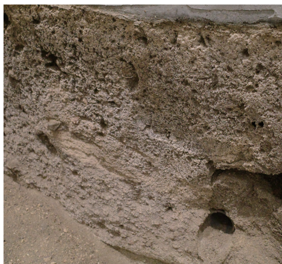
12/15 白い物質析出部分 拡大写真①
