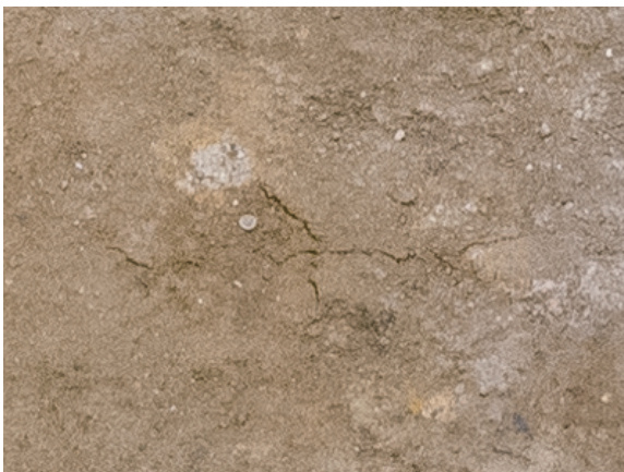
2022/10/13 亀裂 縦約 4.5cm 横約 8.3cm
