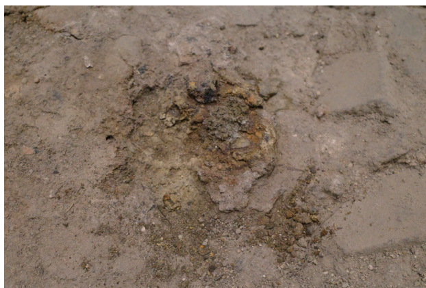
2023/9/14 析出物除去後の様子。
