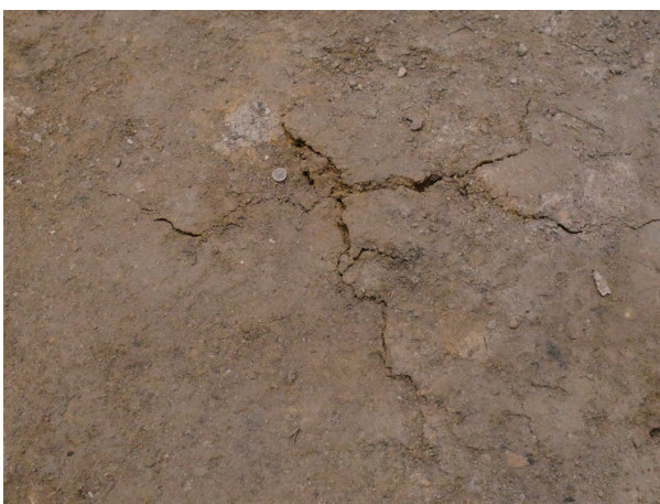
2023/10/13 亀裂 縦約 9.8cm 横約 15.8cm
