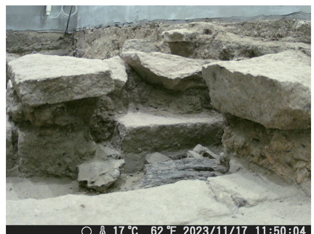
11/13 定点カメラ画像 崩壊後から変化は見られない。
