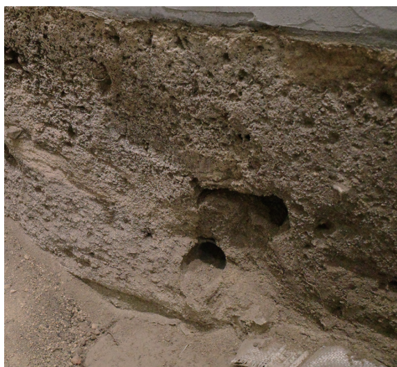
11/17 白い物質析出部分 拡大写真①
