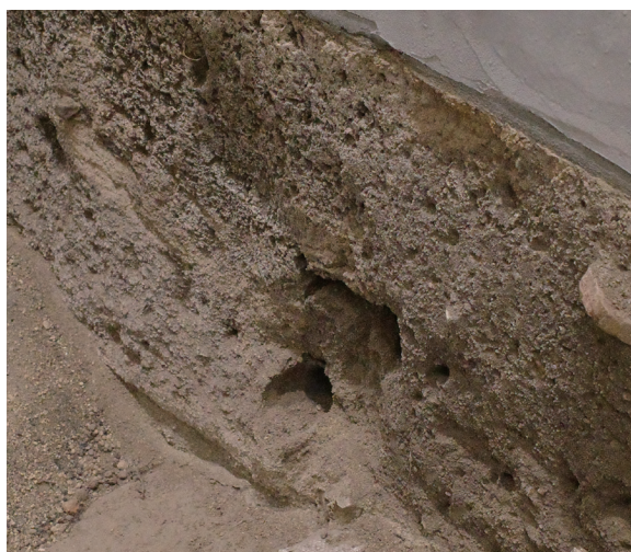
10/13 白い物質析出部分 拡大写真①
