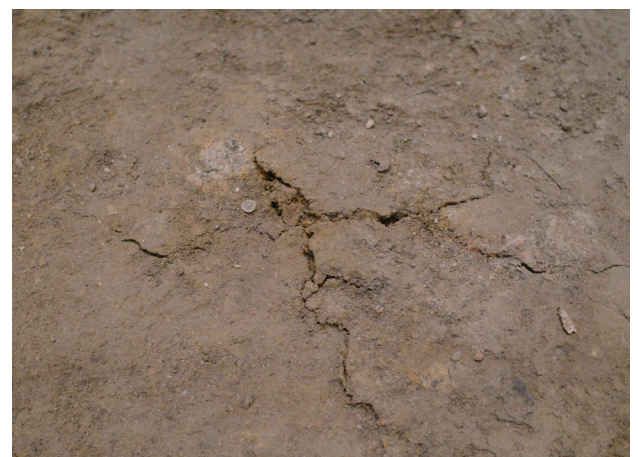
2023/11/17 亀裂 縦約 10.6cm 横約 16.5cm
