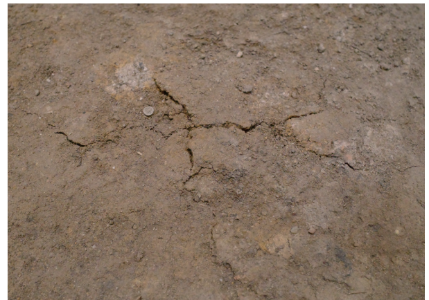
2023/4/24 亀裂 縦約 5.4cm 横約 12.6cm
