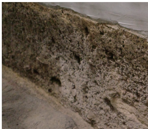
9/14 白い物質析出部分 拡大写真①
