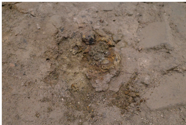
9/14 析出物除去後の様子。
