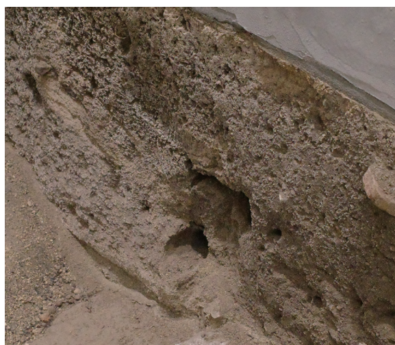
10/13 白い物質析出部分 拡大写真①
