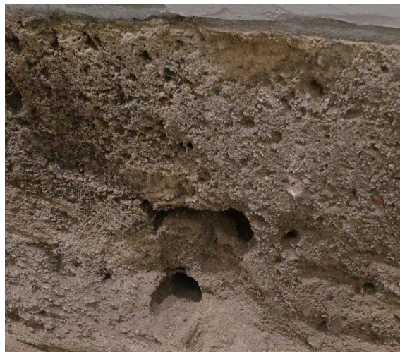
8/21 白い物質析出部分 拡大写真②
