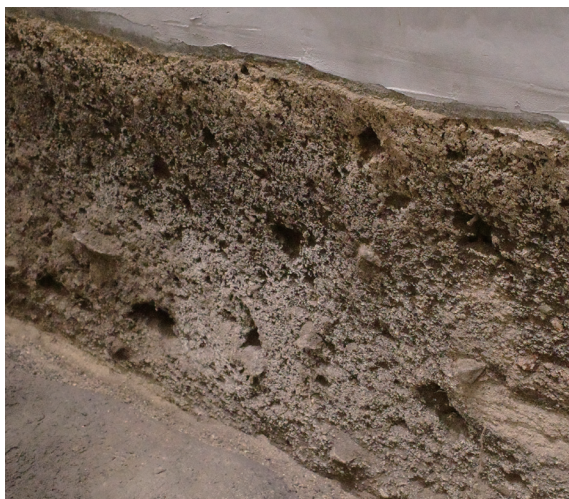
8/21 白い物質析出部分 拡大写真①
