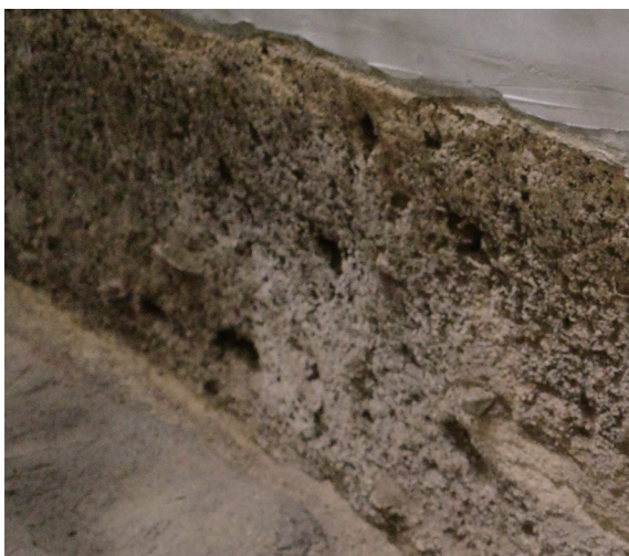
9/14 白い物質析出部分 拡大写真①
