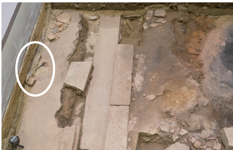
R4/5/16 丸印の部分が崩壊。
