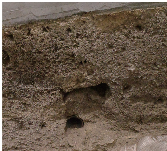
9/14 白い物質析出部分 拡大写真②
