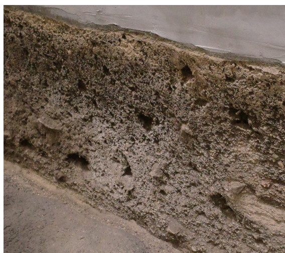
8/21 白い物質析出部分 拡大写真①
