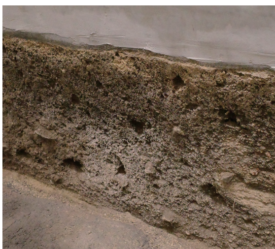
7/18 白い物質析出部分 拡大写真①
