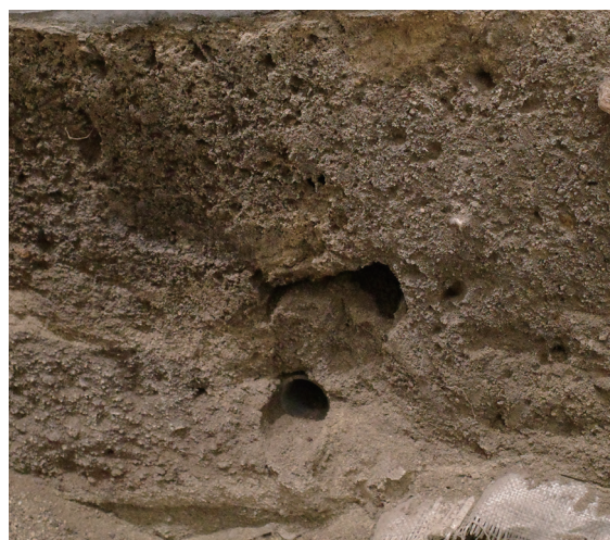
5/16 白い物質析出部分 拡大写真②
