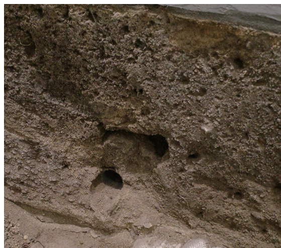
6/15 白い物質析出部分 拡大写真②
