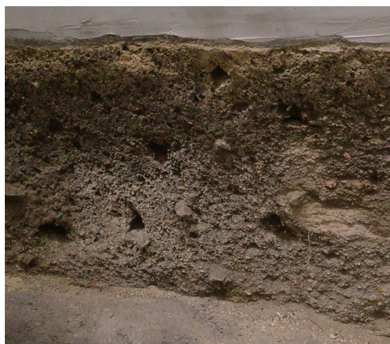
4/24 白い物質析出部分 拡大写真①
