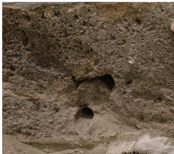
5/16 白い物質析出部分 拡大写真②
