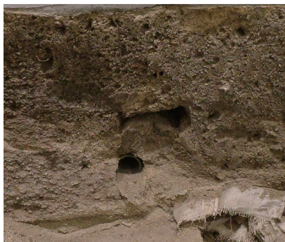
4/24 白い物質析出部分 拡大写真②
