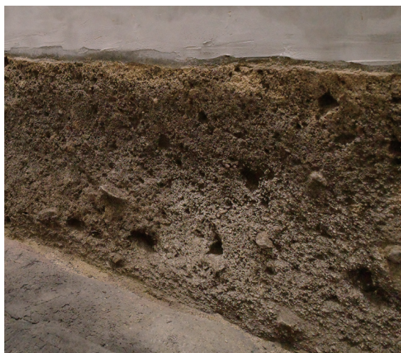
5/16 白い物質析出部分 拡大写真①
