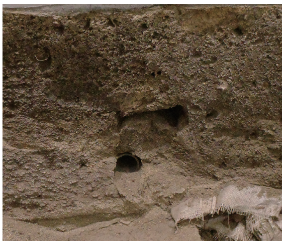
4/24 白い物質析出部分 拡大写真②
