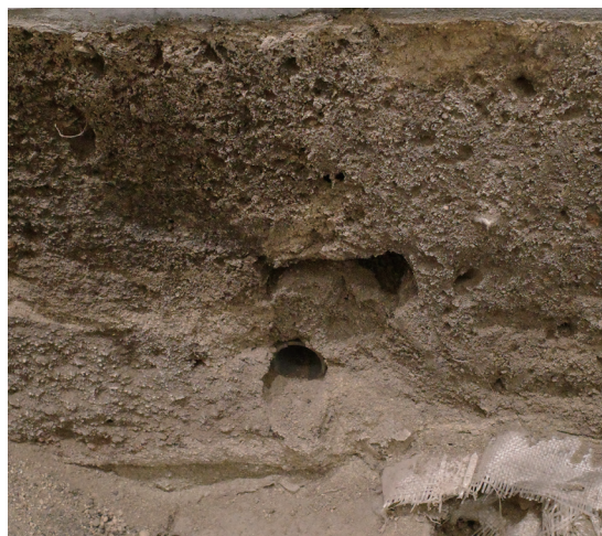
3/13 白い物質析出部分 拡大写真②
