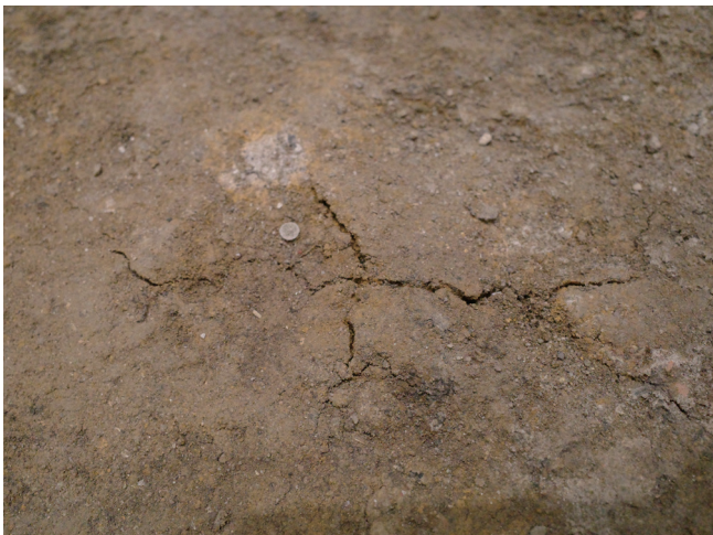
12/14 亀裂の範囲 東西方向：8.7 c m程度 南北方向：4.7 c m程度
