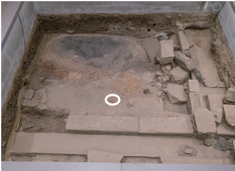
12/14 丸印の部分に亀裂が入っている。
