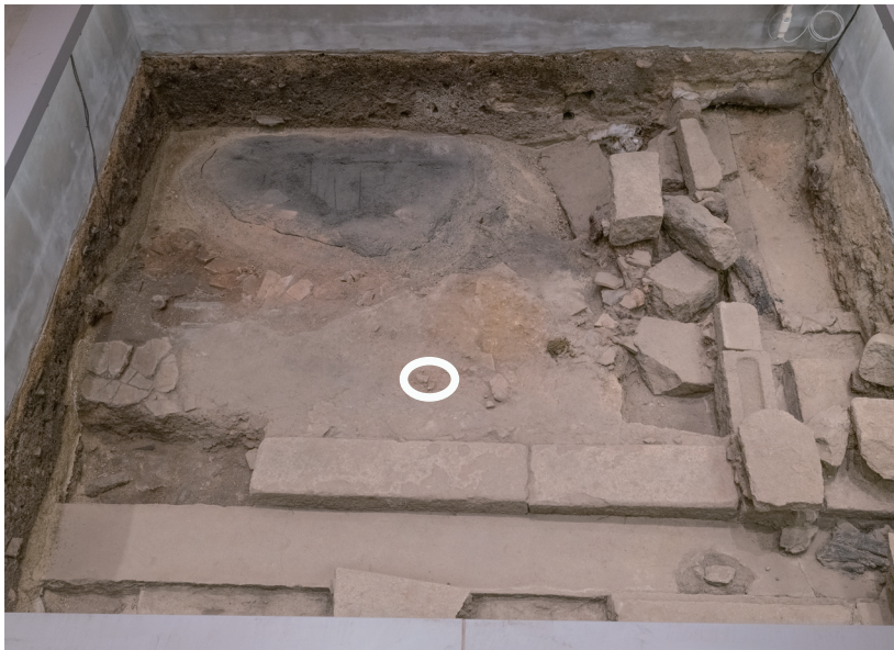
12/14 丸印の部分に亀裂が入っている。
