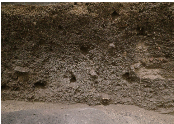
11/16 白い物質析出部分 拡大写真①
