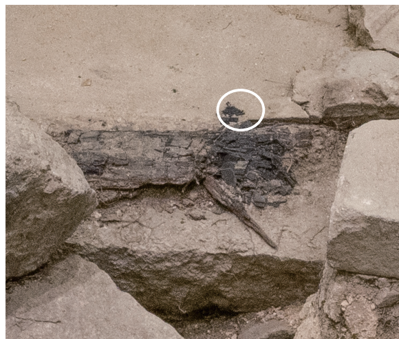
7/14 丸印の部分が5月よりも崩れている。
