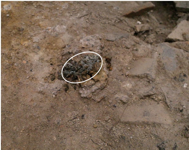
5/16 丸印の部分で、塩が析出か。表層の 割れとともに下層部分が表出。
