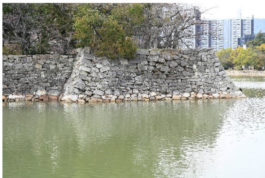
石垣上樹木による石垣変状
