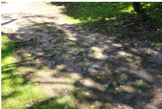
本丸下段西側の土砂流出状況
