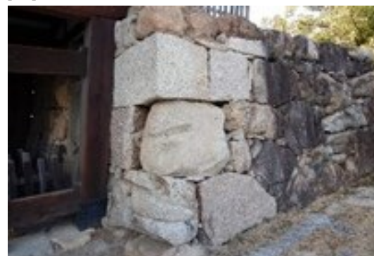
[22] 被爆の痕跡が残る石垣
