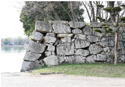
中御門跡の石垣変位状況
