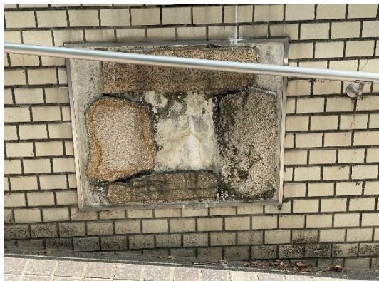
城外展示の劣化
