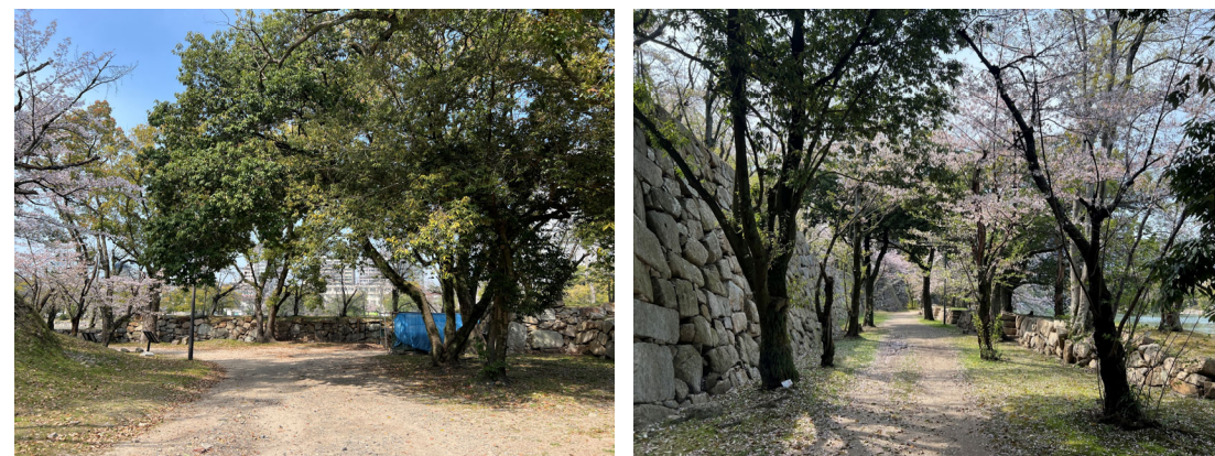
写真11 未舗装路にある支障のおそれがある樹木
