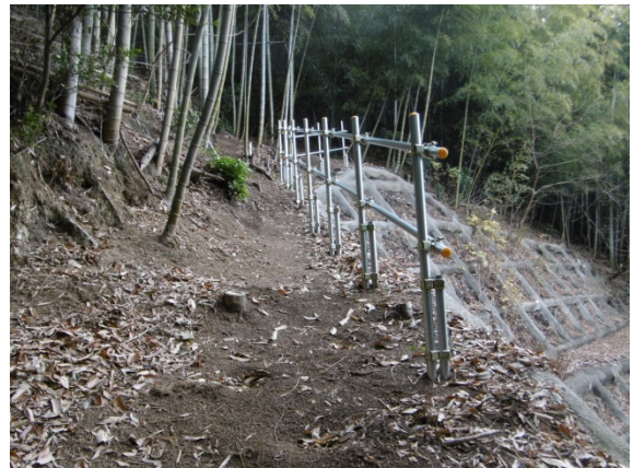
がけ地に沿った里道。仮設の転落防止柵が設置
