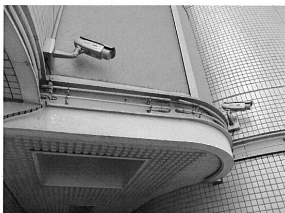
防犯カメラの設置 (薬研堀通り)
