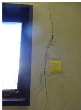
1～2階西側非常用階段壁（亀裂）
