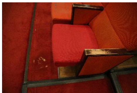
2階上映ホール座席、床劣化
