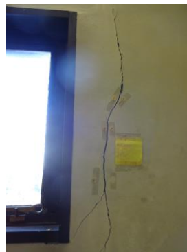
1～2階西側非常用階段壁（亀裂）
