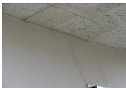
3階セミナー室前倉庫天井（雨漏跡）
