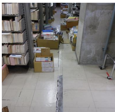
書庫床（床の亀裂と床置き書籍）
