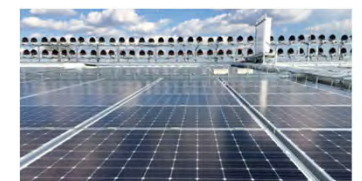
太陽光発電設備
