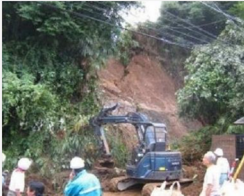
出典：川崎市急傾斜地崩壊対策事業パンフレット
