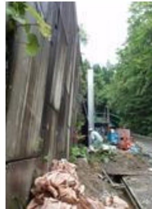
写真 壁面の傾斜の例
