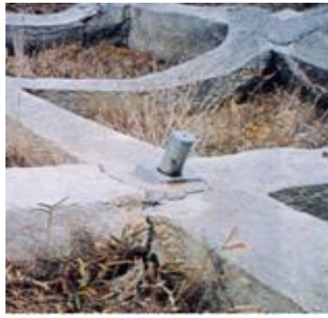
写真 受圧構造物の破損の例
