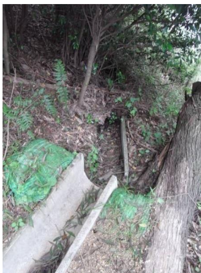
写真 排水溝の破損の例
