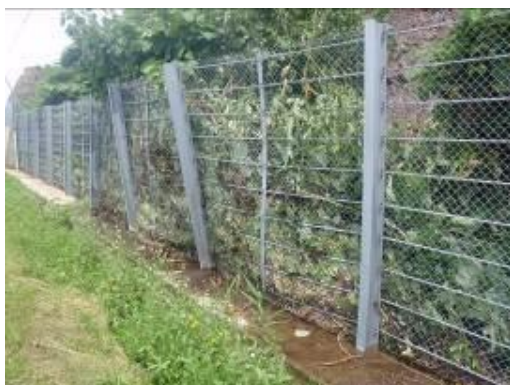
写真 落石防護柵の傾動の例
