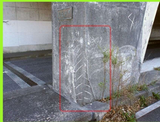
谷側柱部のうき
