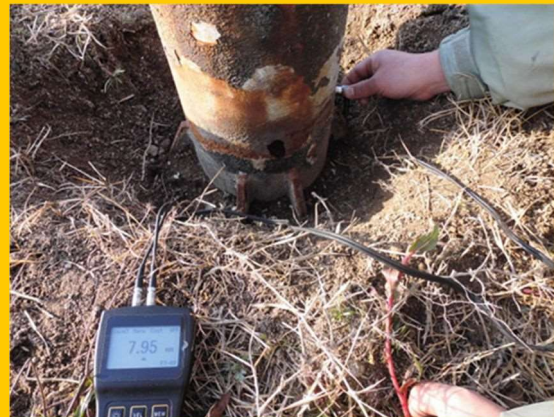
柱脚部（路面境界部）の腐食、貫通
