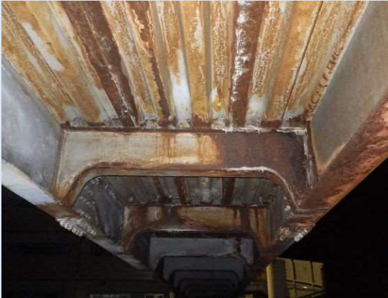
デッキプレートの腐食
