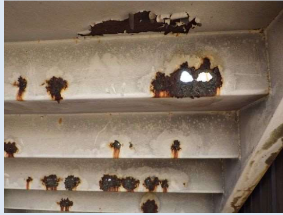
階段部の腐食、貫通
